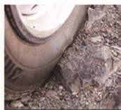
ناهمواری شدید در سطح جاده
